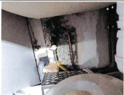
Photo n° PhGaz003 8a2 : au moins un organe de coupure d'appareil n'est pas accessible. Le robinet de commande n'est pas accessible; Faire déplacer le robinet de commande par un installateur gaz qualifié afin de le rendre accessible
