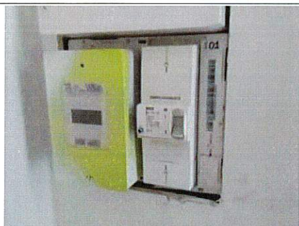
Photo du Compteur électrique
