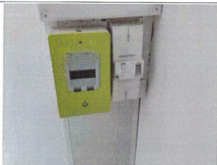
Photo du Compteur électrique
